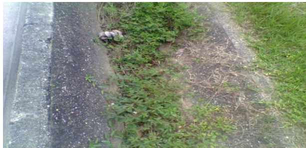
Figura 24. Canal de agua obstruido por falta de mantenimiento.
